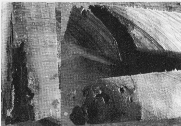
Figura 10. Daño de la parte central del árbol causado por el ataque de termitas.
